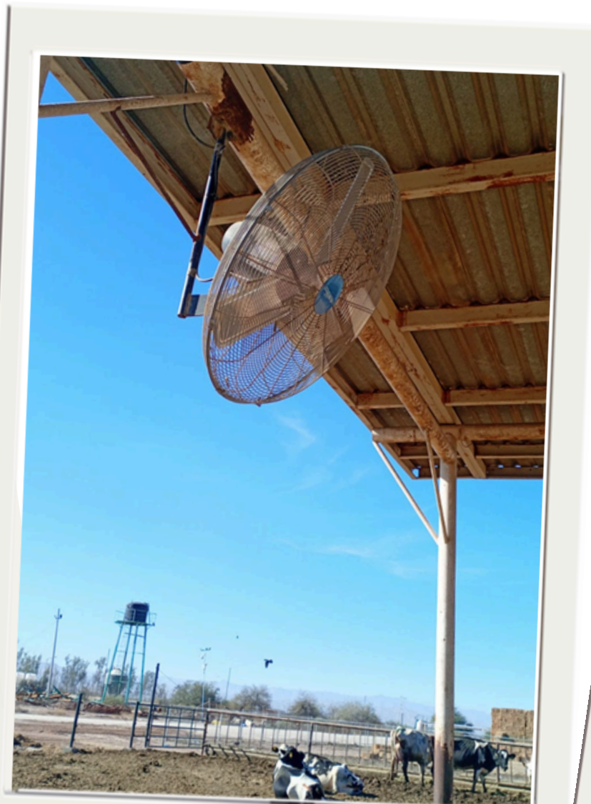
Ventilador de pared, ubicado corrales de bovinos
